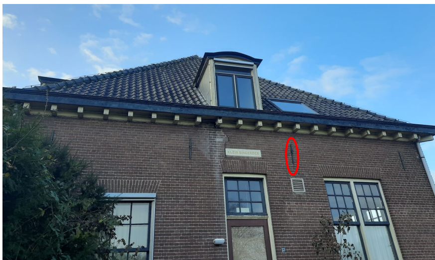
Figuur 3.1: Invliegopening luchtpouw achter muuranker waar kraamkolonie is aangetroffen
