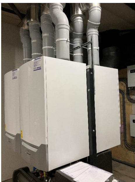
In de installatieruimte zijn recentelijk nieuwe gasketels geplaatst.
